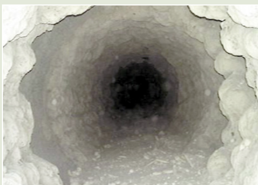
Figura 17. 4. Riesgo de desprendimiento
