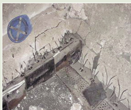
Figura 17. 5. Empleo inadecuado de EPI's
