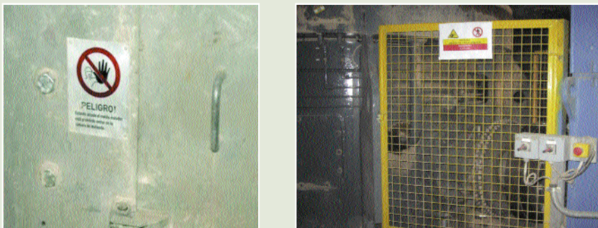
Figura 18. 9. Carteles de peligro
