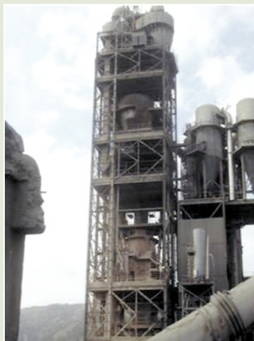
Figura 16. 1. Torre de ciclones
